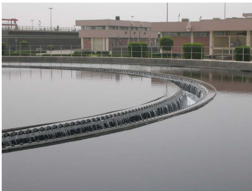
Fig. 5.5.5 Sedimentatori secondari dell'impianto di depurazione di Gabal El Asfar ( Il Cairo)
