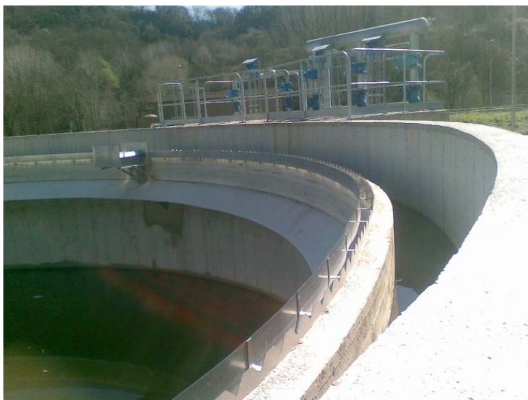
Fig. 5.5.7 Foto Stamford Baffle installato su un sedimentatore secondario- Impianto di Civita Castellana.
