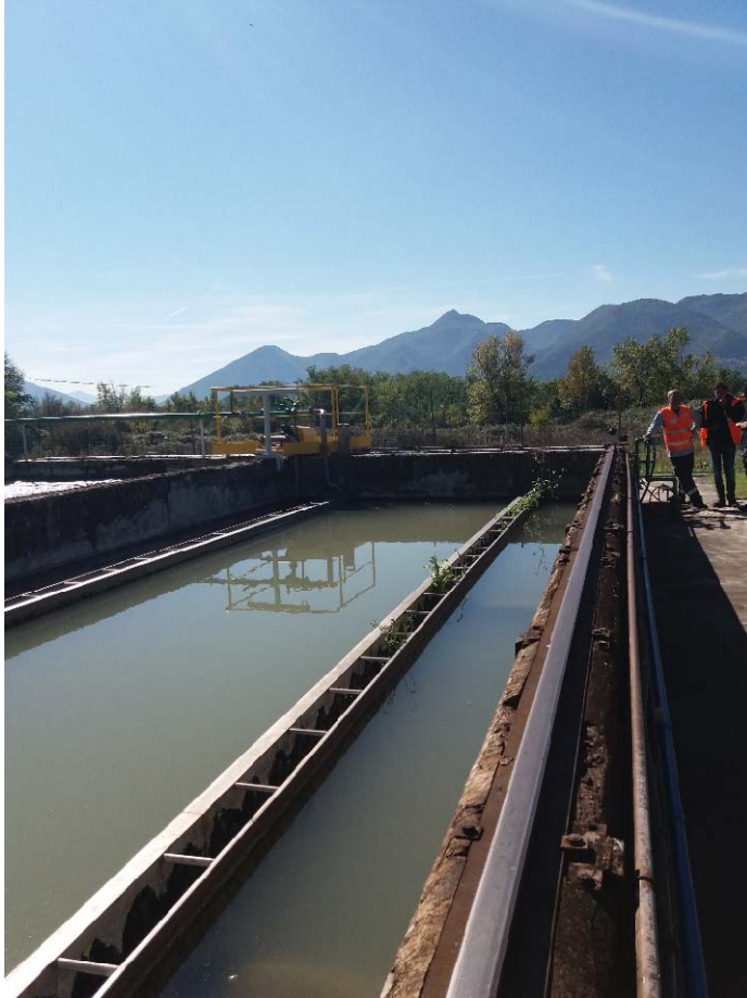
Fig.5.4.3 Sedimentatore secondario con canalette di gronda longitudinali, parallele al lato lungo
